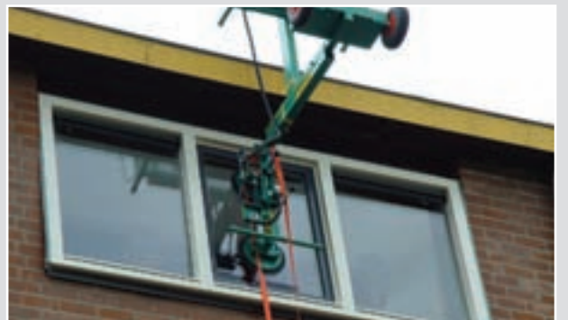
Het geheel afgewerkte gevelkozijn wordt arbo-vriendelijk in een handomdraai geplaatst, via een handige klikverbinding.
